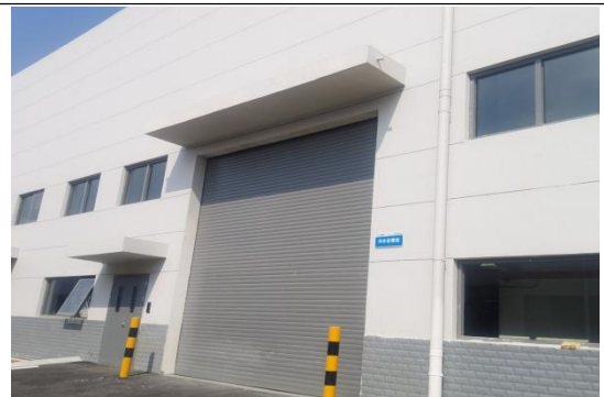
厂区污水处理站（本工程依托）
