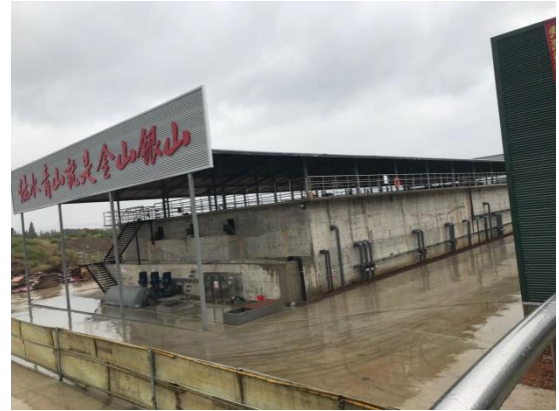
照片 2 项目区已建成气浮池、清水池
